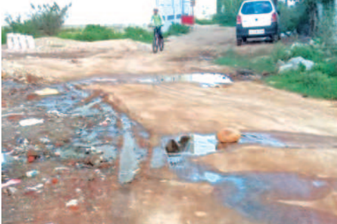
డ్రైనేజీ నిర్మాణాలు లేక రోడ్డు పారుతున్న మురుగునీరు
